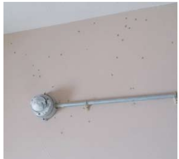
Murs endommagés par des balles de fusil et caméra recouverte de peinture
